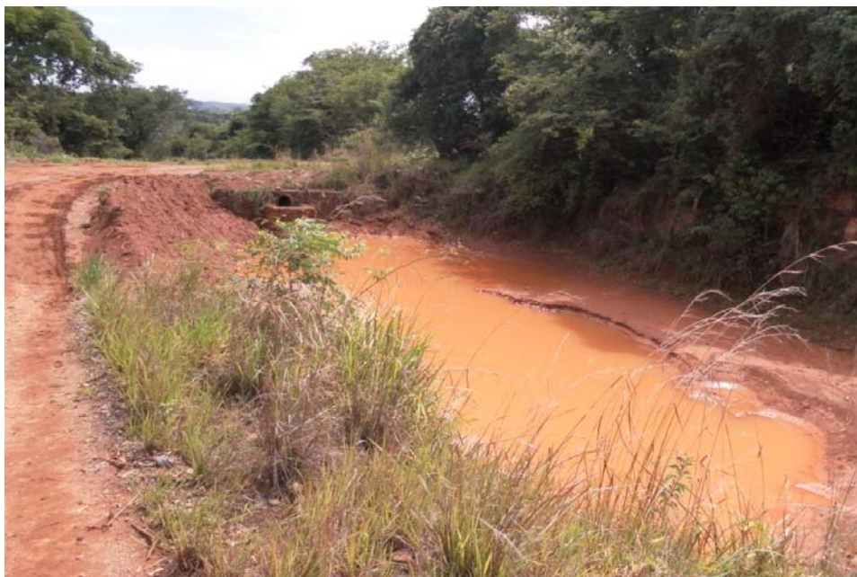
Figura 29 – Sistema de drenagem. Vala de captação das enxurradas.
